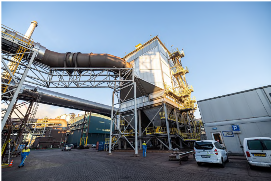
Figuur 4.11 De nieuwe Elektrofilterinstallatie bij de Sinterfabriek, de buis in de achtergrond leidt naar de oude Elektrofilterinstallatie
