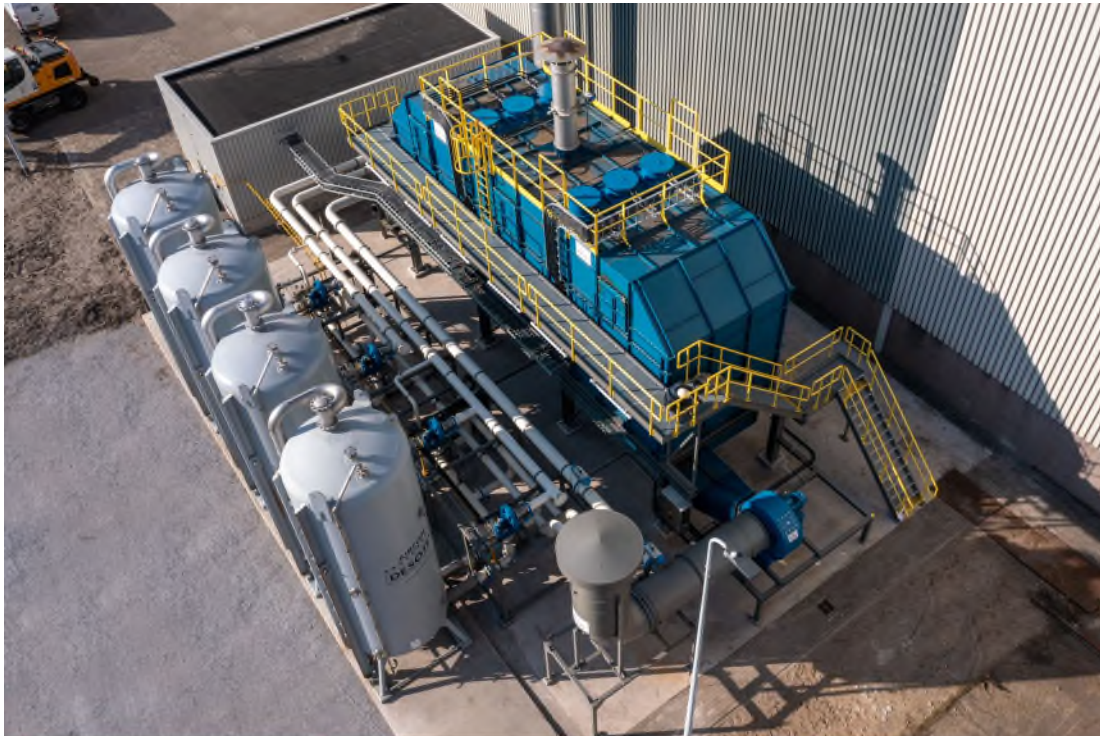
Figuur 4.18 De gasreinigingsinstallatie bij de Koudbandwalserij
