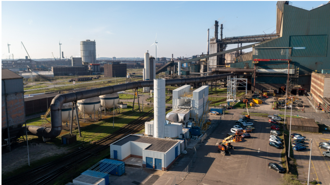
Figuur 4.7 De tertiaire afzuiginstallatie van de Staalfabriek, met op de voorgrond de doekfilterinstallatie
