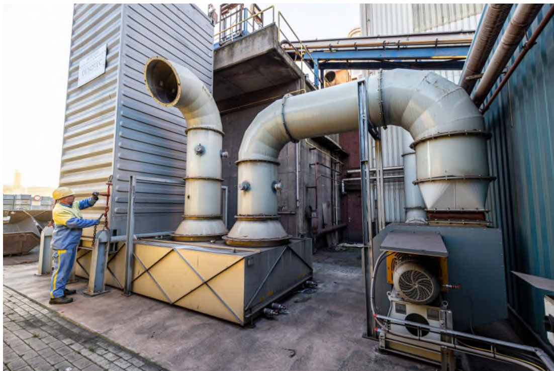
Figuur 4.17 Milieu-installatie bij de Hulpstoffenfabriek van de Hoogovens met daarin actief kool, dat PAK-stoffen filtert
