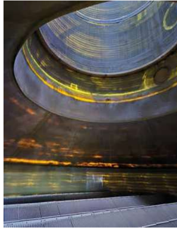
Boven de druppelvanger in de nieuwe DeNOx-fabriek rijst de 65 meter hoge schoorsteen op. FOTO: DE INGENIEUR
